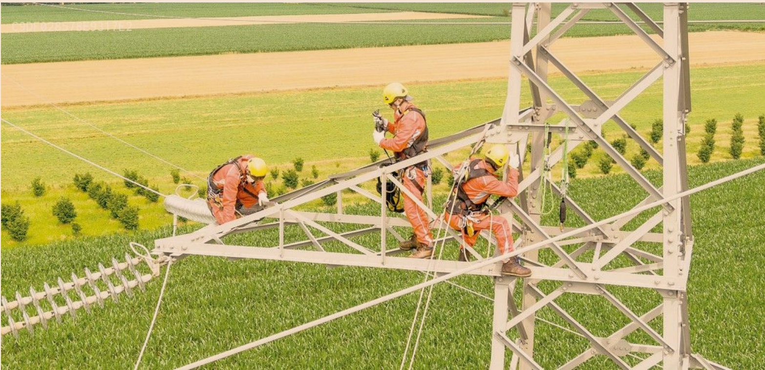
Infrastrutture. L'ammodernamento delle reti elettriche è uno dei pilastri al centro del nuovo pacchetto di finanziamenti targati Bei
